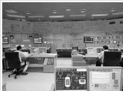
Do provozu byla uvedena nově rekonstruovaná dozorna 3. bloku
